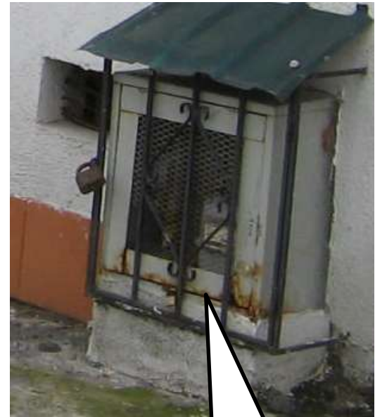
Rejas en Centros de Medición
